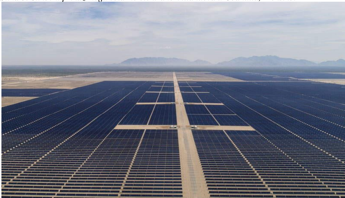
Slika 5. Slikovni prikaz mega solarne elektrane Villanueva u Coahuila, Meksiko.
